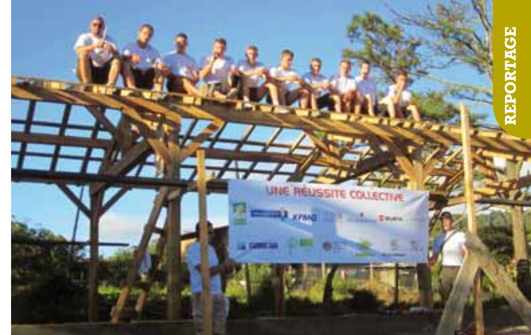
→ En quatre jours, apprentis charpentiers et artisans chevronnés bâtissent l'ossature d'une salle destinée aux jeunes d'une communauté nicaraguayenne.
